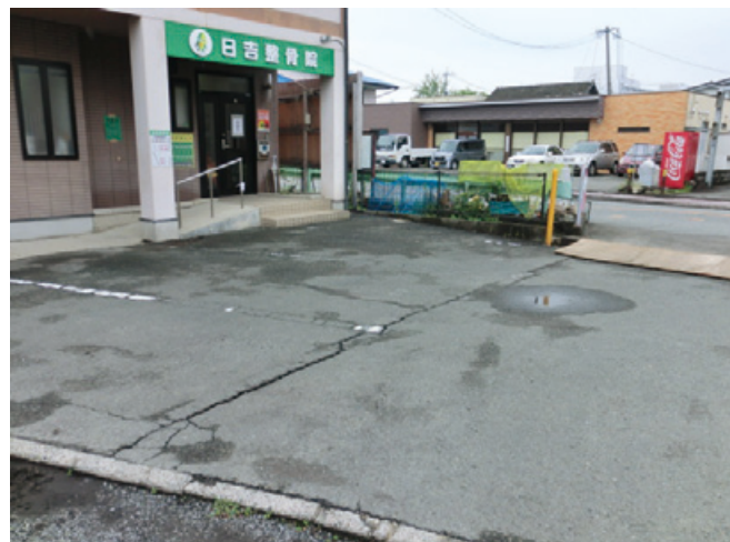
駐車場に地割れ
