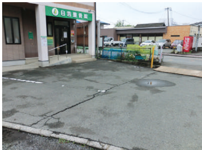
駐車場に地割れ
